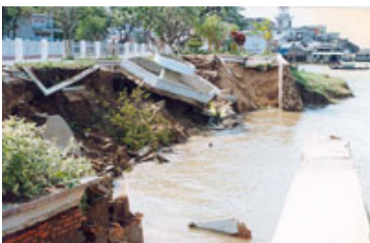
Sạt lở bờ sông Cửu Long (43)
